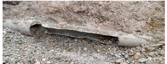
Defektes Trinkwasserrohr in Klettham
